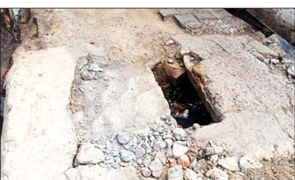
ललितपुर। गाँधीनगर में क्षतिग्रस्त पुलिया।
